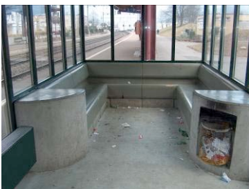
verschmutzte Wartehäuschen sind für die ÖV-Benützer unattraktiv und fördern Vandalismus
